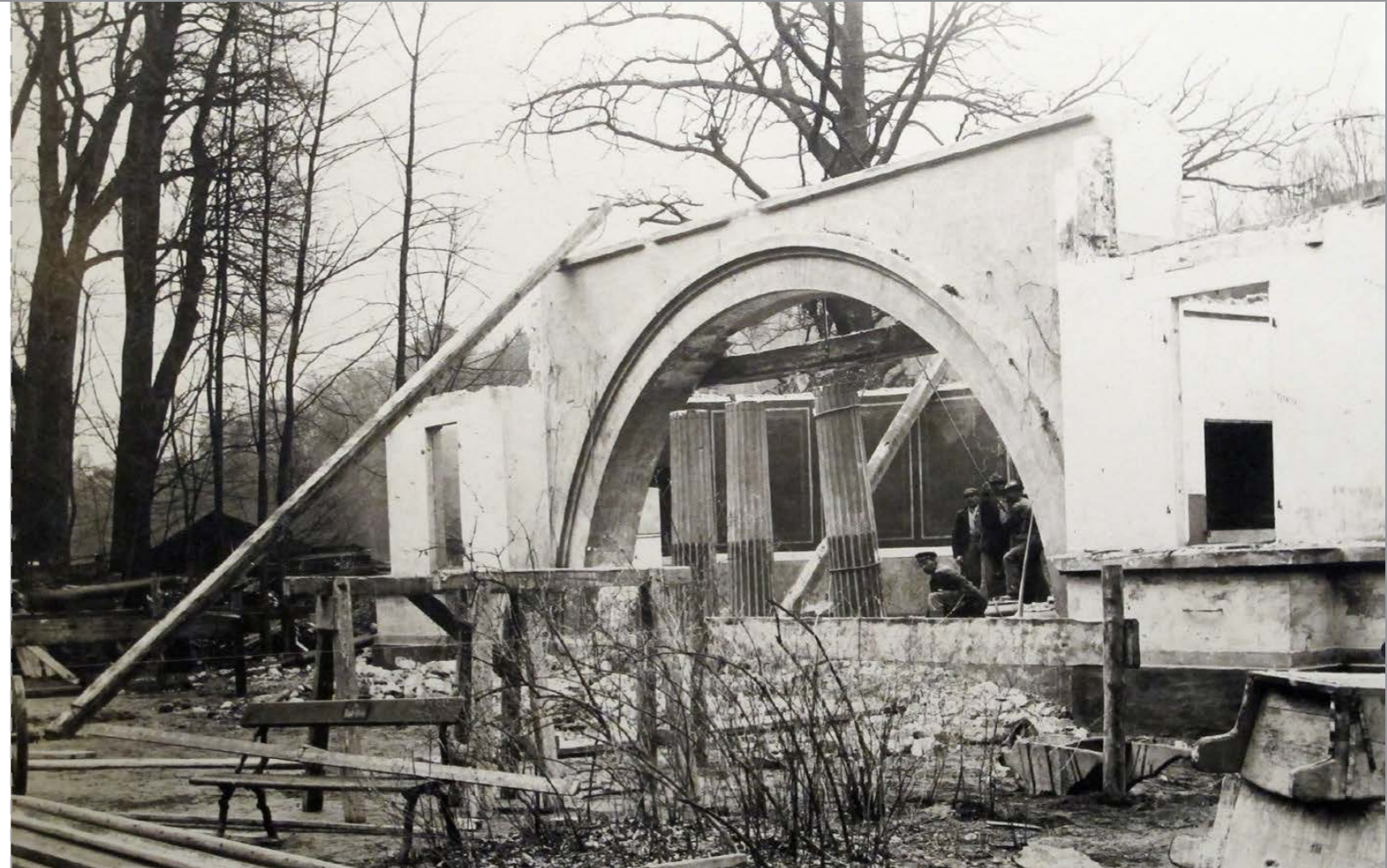
Abbruch des Badehauses SALUBRITATI im Jahr 1914. Es war 1815 nach einem Entwurf des Ingenieuroffiziers Ferdinand Freiherr von Hohenhausen, der seit 1806 als Vorstand der bayerischen Staatsbauverwaltung in der Provinz Bamberg amtierte, errichtet worden. Die Fassade war auf den Theresienhain ausgerichtet, die Rückseite wandte sich dem Fluss zu. Links im Bild ist hinter den Bäumen das Flussbad für Damen erahnbar
